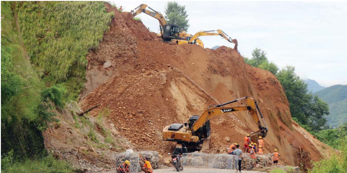
अवरुद्ध सडक खुलाउने प्रयास गरिदै | भोटेकोशी हुँदै त्रिशूली नदीमा आएको बाढीको कटानले क्षति पुऱ्याएको गल्छी-देवीघाट सडकखण्ड अन्तर्गत बेलकोटगढी-७ छबिसेमा सडक खुलाउन प्रयास गर्दै । तस्विर: रासस
