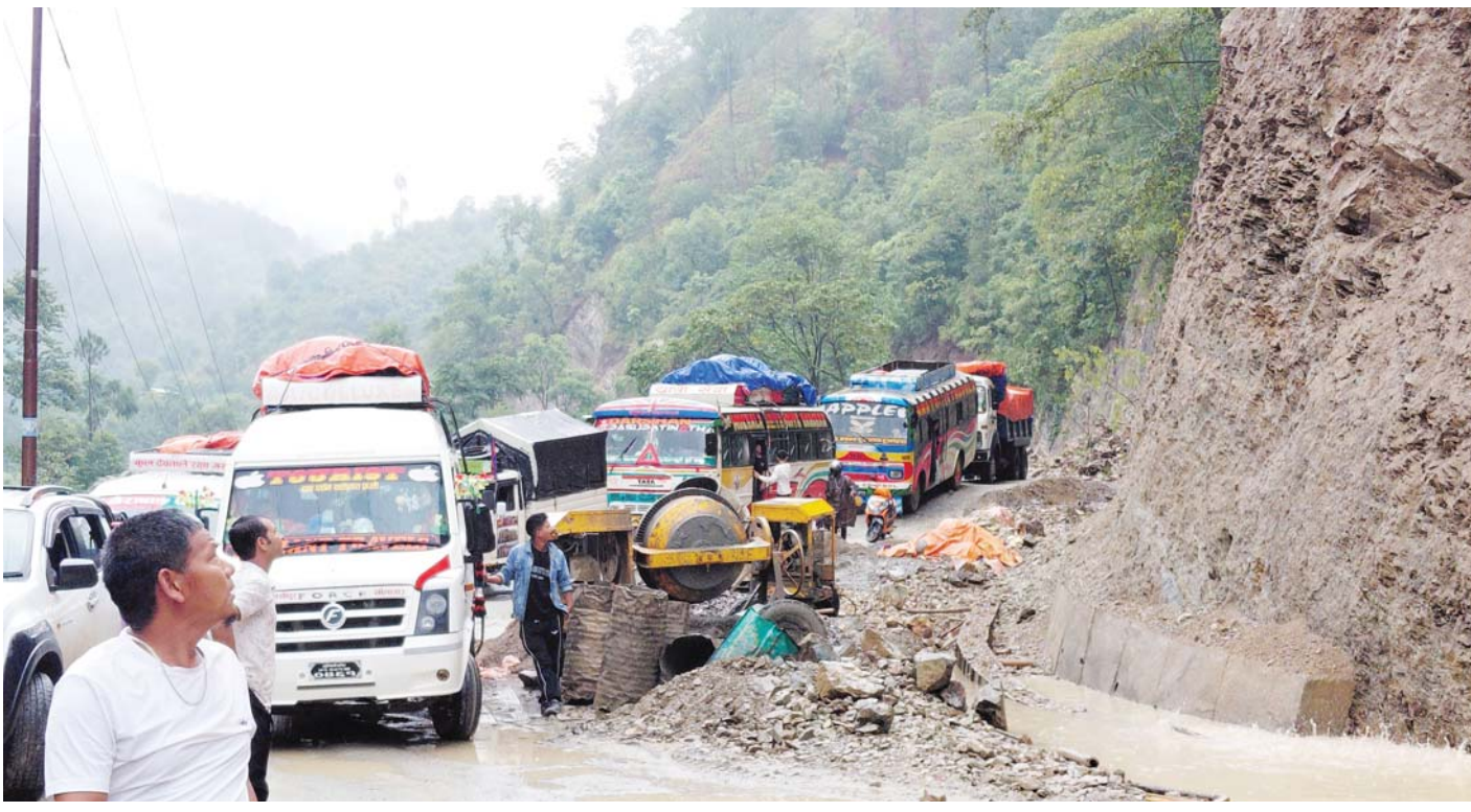
पहिरोले रोकिएका गाडी | राप्ती लोकमार्गअन्तर्गत तुलसीपुर-सल्यान सडक खण्डको कपुरकोटमा मंगलबार भएको पहिरो हटाउने क्रममा रोकिएका गाडी ।
