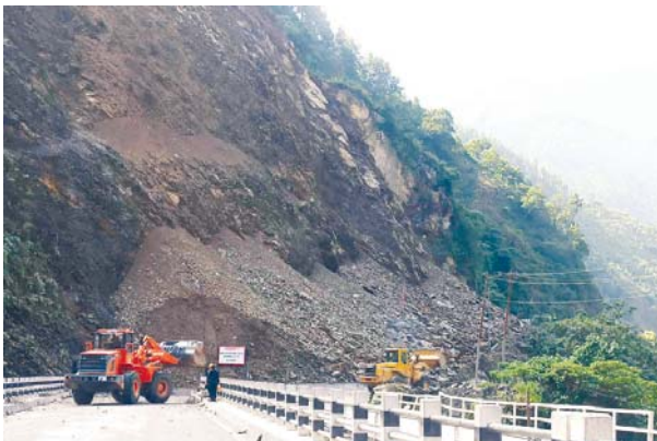
तुइन खोलामा खसेको पहिरोले अवरुद्ध मुग्लिन-नारायणगढ सडकखण्ड । तस्विर: रासस
